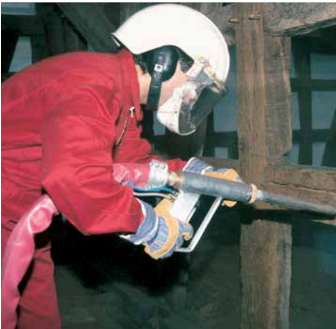
Tragen Sie beim Trockeneisstrahlen (z.B. beim Renovieren eines alten Fachwerkhouses, wie hier zu sehen) immer Schutzkleidung.
