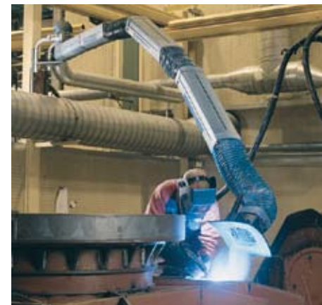
Absaugung im Entstehungsbereich Bild: Nederman
